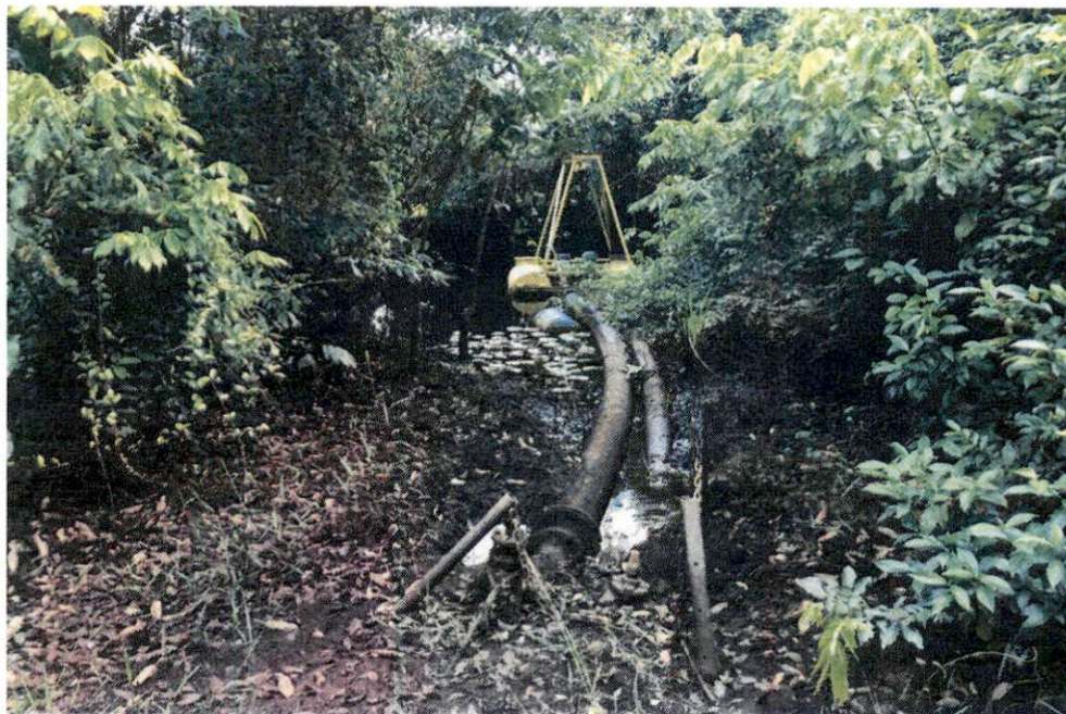
Captação superficial no Rio Coca-Cola (atualmente desativada)
