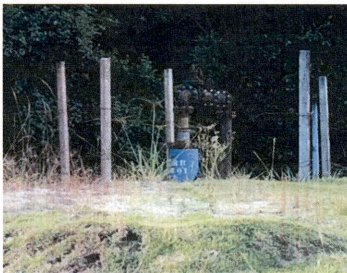
Captação profunda POÇO 01
