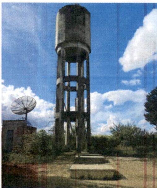
Reservatório elevado 50 m 3 . Fonte: Arquivo Prefisan.
