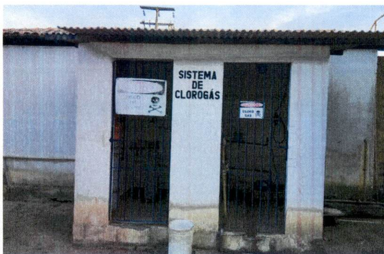
Sistema de Cloro Gás. Fonte: Arquivo Prefisan.
